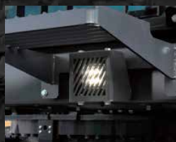
1 en dessous de la cabine
