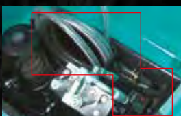
Pompe gasoil Pompe à arrêt automatique et accessible depuis le sol.
