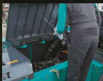
Entretien du moteur Accès moteur sécurisé par une plateforme de maintenance.
