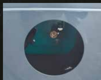
Vanne de vidange du réservoir gasoil et trappe d'inspection
